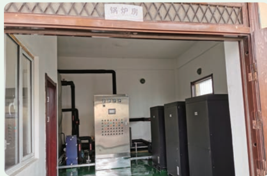
改造后的锅炉房
